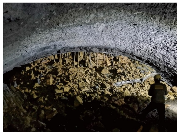
图 6 隧道坍塌 Fig.6 Tunneling collapse
