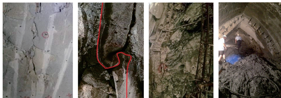
a 混凝土开裂 b 边墙挤压变形 c 钢架扭曲 d 隧道内坍塌
