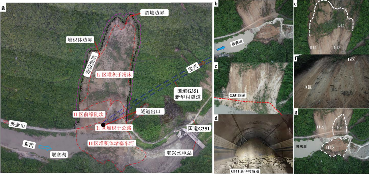
图 12 高位滑坡震损图
