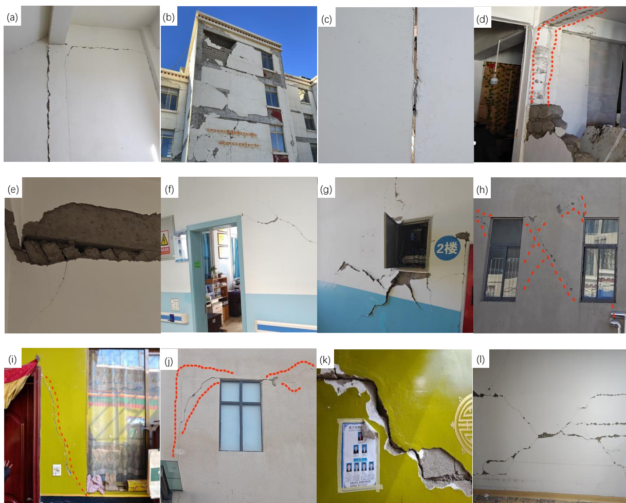
图 12 填充墙震害；（a）交接处震害(拉孜县曲下镇曲下村Ⅶ度区)；（b）交接处震害(定日县曲洛乡左措村Ⅸ度区)；（c）交接处震害(定日县加措乡门当岗村Ⅶ度区)；（d）不设拉结筋(拉孜县芒普乡查普村Ⅶ度区)；（e）填充墙顶斜砌(拉孜县曲下镇
