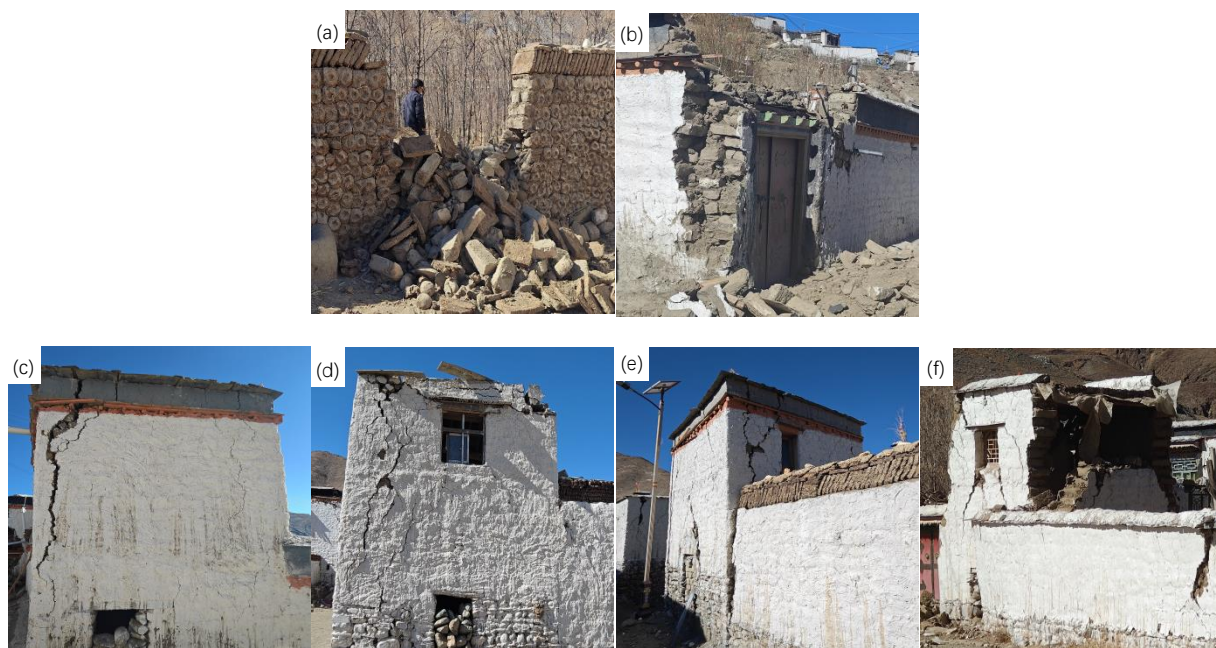
图9 非承重构件及附属结构的震害;(a)围墙倒塌(拉孜县查务乡查务村Ⅶ度区);(b)围墙大门门头掉落(拉孜县查务乡查务村Ⅶ度区);
