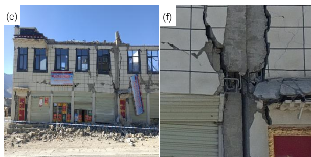
图 14 砌体结构震害；(a) 承重墙开裂(拉孜县拉孜镇拉龙村Ⅵ度区)；(b) 承重墙开裂(拉孜县拉孜镇拉龙村Ⅵ度区)；(c) 承重墙开裂(定日县加措乡拉龙村Ⅵ度区)；(d) 窗间墙受损(拉孜县查务乡查务村Ⅶ度区)；(e) 屋盖滑落(定日县曲洛乡噶白村Ⅸ度区)；(f) 节点受损(定日县曲洛乡噶白村Ⅸ度区)
