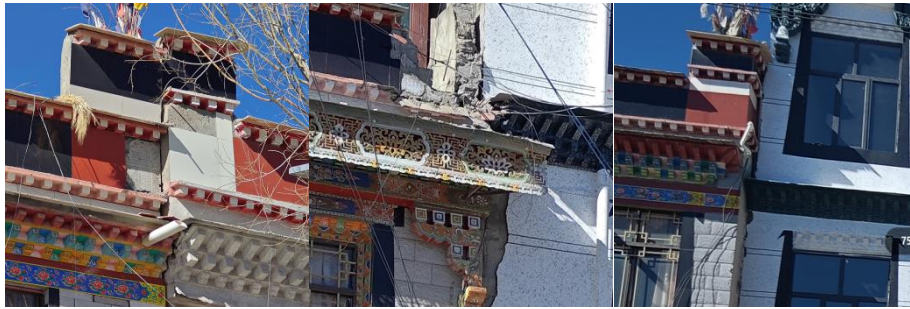
图 13 建筑碰撞的震害
