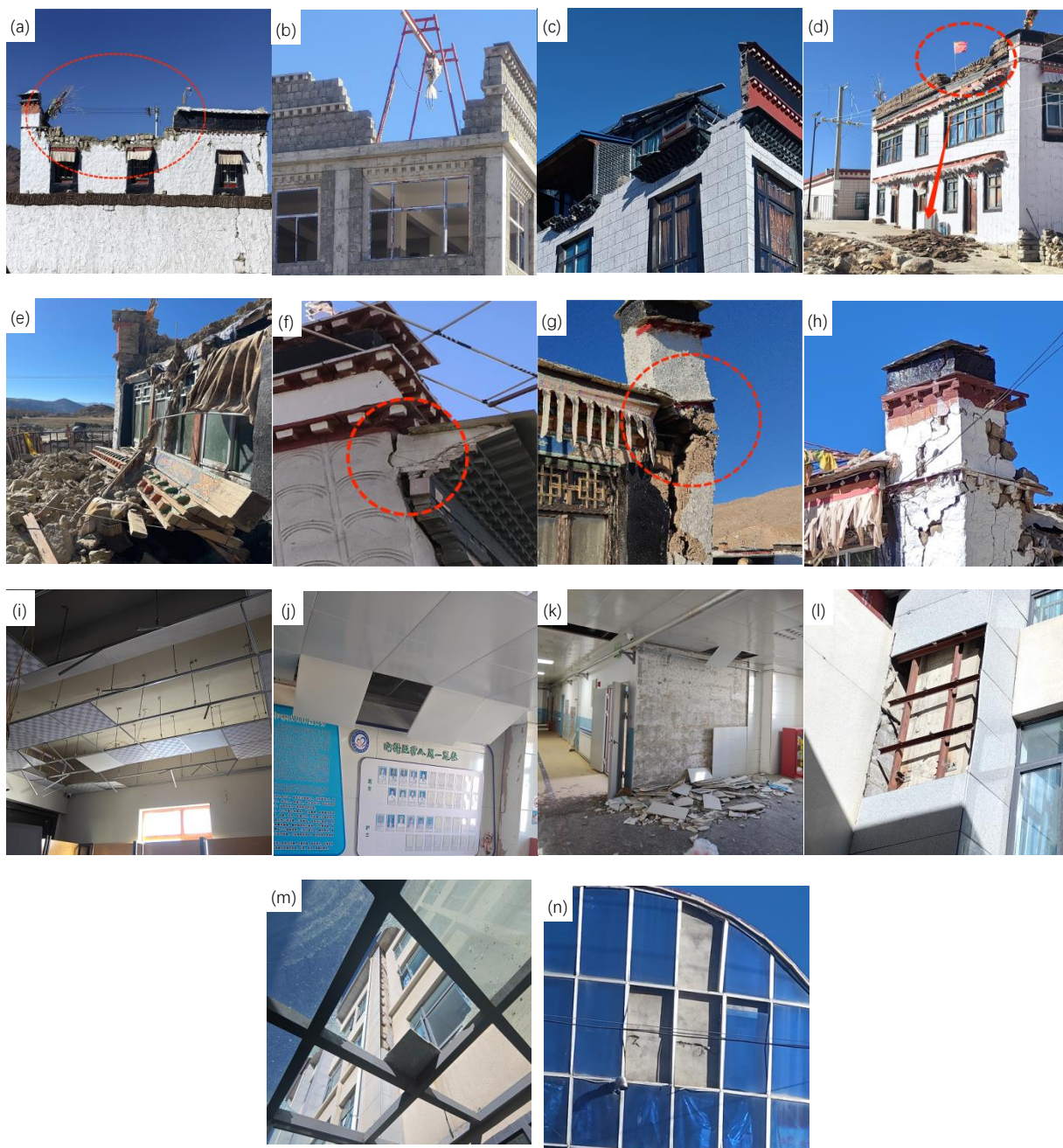
图 15 非承重构件震害：(a) 女儿墙掉落(拉孜县拉孜镇拉龙村，Ⅵ度区)；(b) 女儿墙掉落(拉孜县拉孜镇拉龙村，Ⅵ度区)；(c) 女儿墙掉落(拉孜县曲下镇曲下村，Ⅶ度区)；(d) 牛粪砖散落(拉孜县曲下镇曲下村，Ⅶ度区)；(e) 装饰斗拱掉落(拉孜县拉孜镇拉孜村，Ⅵ度区)；(f) 装饰斗拱开裂((拉孜县拉孜镇拉孜村，Ⅵ度区)；(g) 风旗插台断裂(拉孜县拉孜镇拉孜村，Ⅵ度区)；(h) 风旗插台受损(拉孜县曲下镇曲下村，Ⅶ度区)；(i) 民用房吊顶损坏((拉孜县曲下镇市区，Ⅶ度区)；(j) 公用房吊顶损坏(拉孜县曲下镇市区，Ⅶ度区)；(k) 瓷砖掉落(拉孜县曲下镇市区，Ⅶ度区)；(l) 管道包柱受损(拉孜县曲下镇市区，Ⅶ度区)；(m) 玻璃受损(拉孜县曲下镇市区，Ⅶ度区)；(n) 玻璃受损(拉孜县曲下镇市区，Ⅶ度区)
