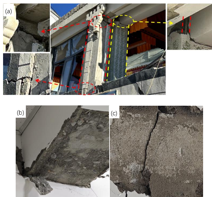
图 11 承重构件的震害 (a) 柱体开裂(定日县曲洛乡嘎白村IX度区)；(b) 梁头混凝土剥落(拉孜县中心医院VII度区)；(c) 梁中开裂(拉孜县芒普乡幼儿园VII度区)
