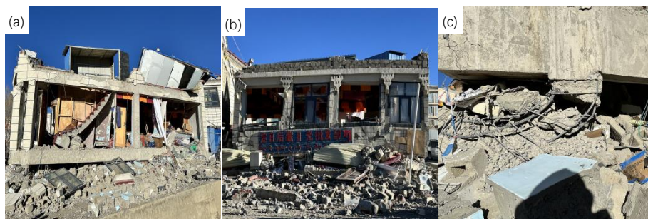
图 10 框架结构倒塌；(a) 底层倒塌(定日县曲洛乡嘎白村IX度区)；(b) 底层倒塌(定日县曲洛乡嘎白村IX度区)；(c) 柱子配筋率不足(定日县曲洛乡嘎白村IX度区)
