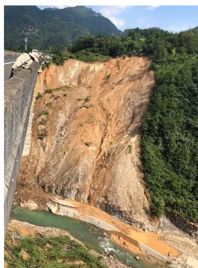
图5-11 节理面为控制面的崩塌
