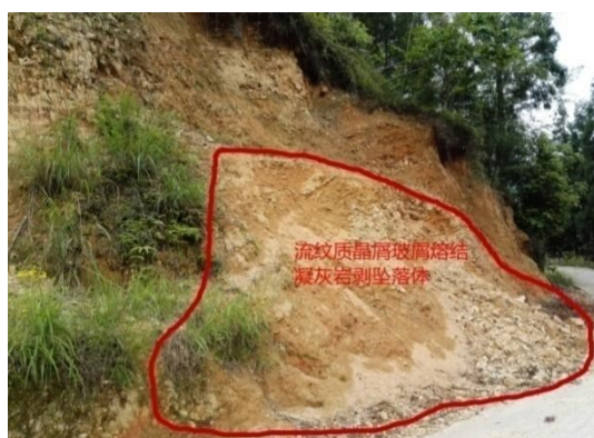
图5-1 全风化熔结凝灰岩滑坡
