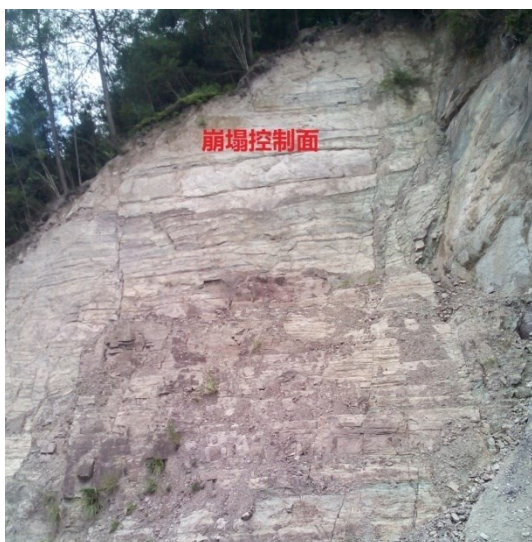
图5-10 软弱夹层控制面形成的崩塌
